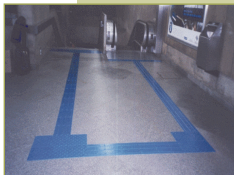
Foto 14 - Piso tátil direcional na Estação do Metrô Vergueiro. São Paulo, 2002.
